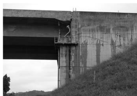
写真-1 桁衝突による橋台損傷事例
