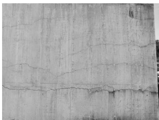
写真-5 P2橋脚の山側におけるひび割れ状況
