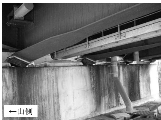
写真-1 A1橋台における支承の破断
