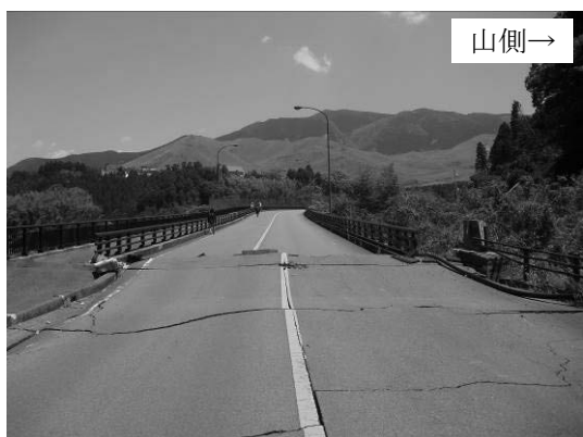
写真-2 A1橋台側から見た桁の橋軸直角方向へのずれ
