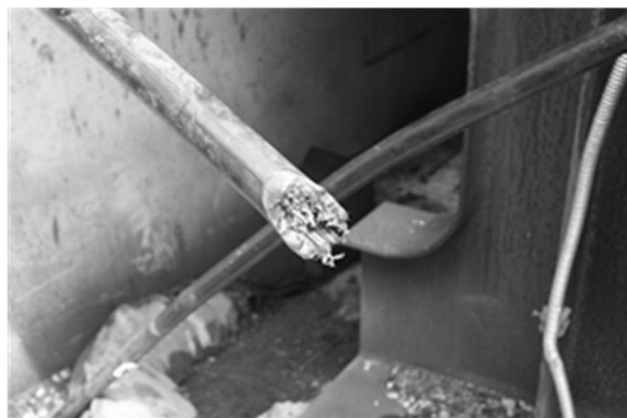
(b) ケーブルの破断部
