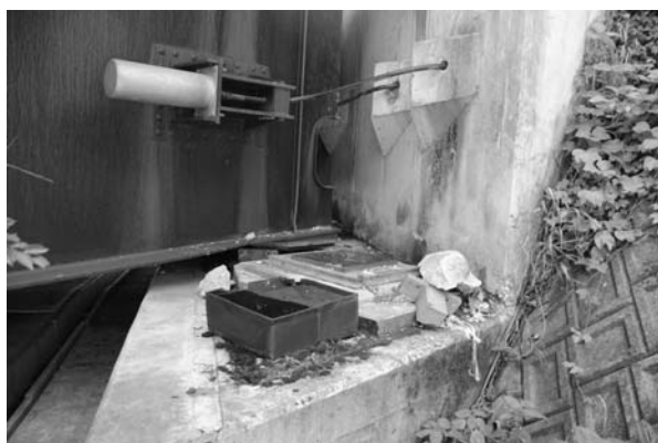
(a) 上部構造を支持するゴム支承の破断
