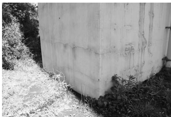
(b) 下部構造のひび割れ
