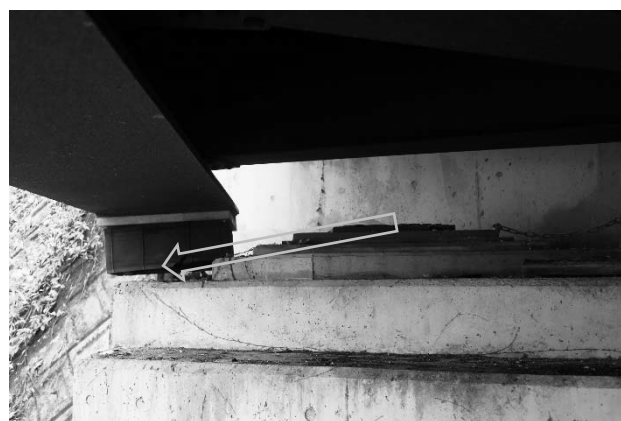
図-10 大切畑大橋阿蘇側の支承部の変状
