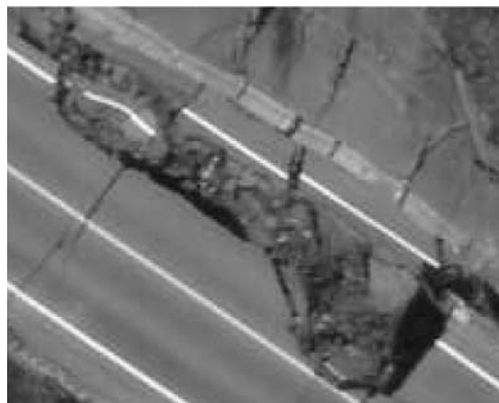
(c) 俵山大橋西原側の陥没
