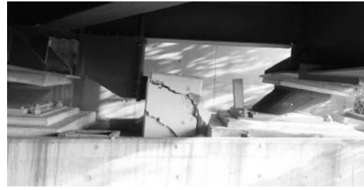
(ii) 横変位拘束構造の破壊
