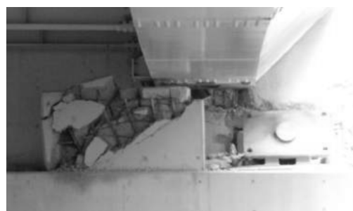
(ii) 横変位拘束構造の破壊
