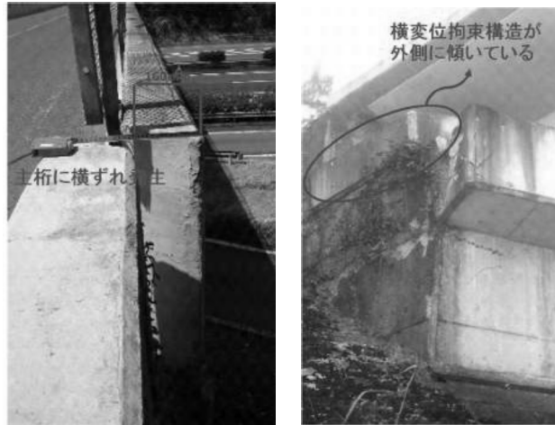
図-6 府領第一橋の前震後の桁の橋軸直角方向変位 (NEXCO 西日本提供写真に加筆)
