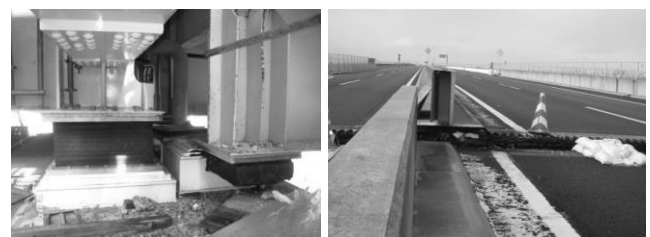
(a) ゴム支承の破断
