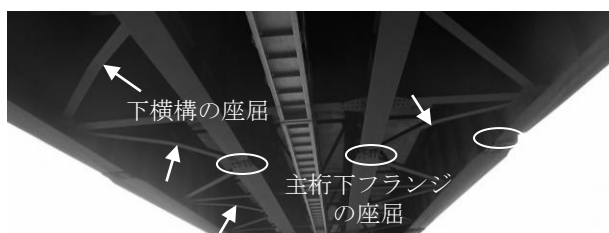
写真-1 A1とP1間の主桁の鋼部材座屈
