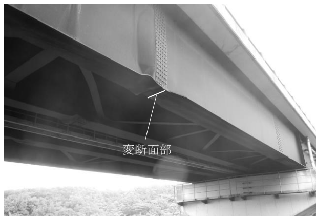
写真-2 変断面部の主桁座屈
