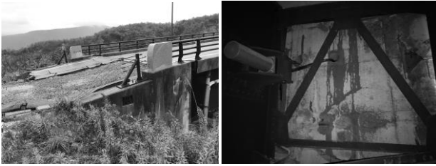
写真-6 橋台の被害状況
