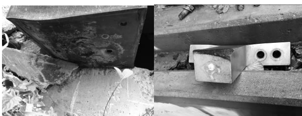
写真-4 逸脱した支承とサイドブロック
