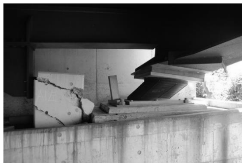
写真-5 A1橋台橋軸直角方向への残留変形
