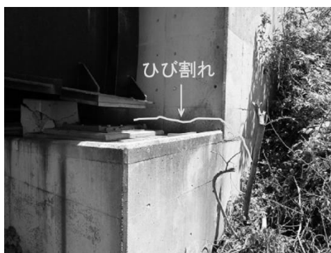
写真-2 A1側パラペットの損傷
