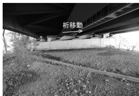
写真-3 A1橋台橋軸直角方向への桁移動
