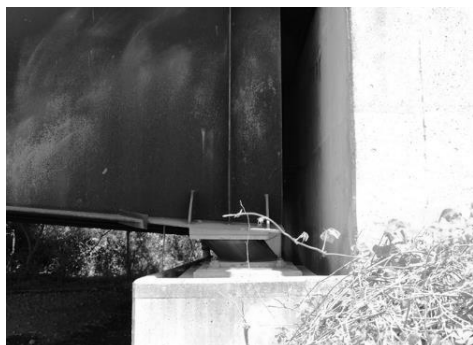
写真-4 A1橋台橋軸方向への残留変形
