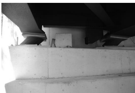
写真-6 A2橋台橋軸直角方向への残留変形
