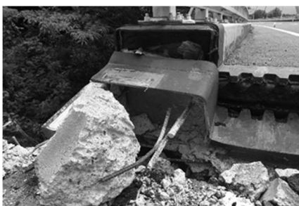
写真-7 A2 伸縮装置の破壊
