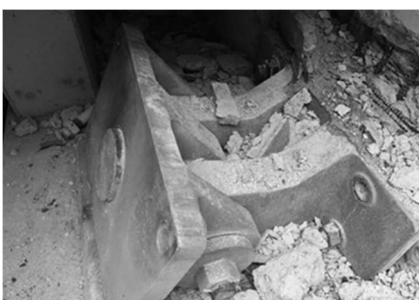
写真-4 A2 山側支承の破壊
