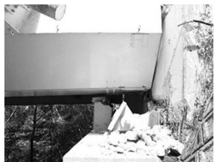
写真-3 A2 パラペットの破壊
