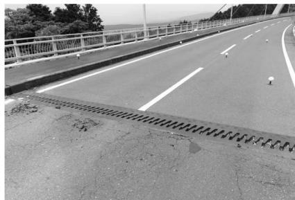
写真-6 A1 伸縮装置のずれ
