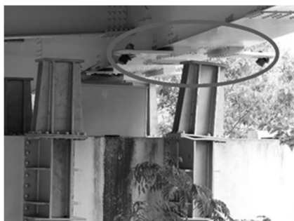
写真-2 変位制限構造の鉛直ボルト破断
