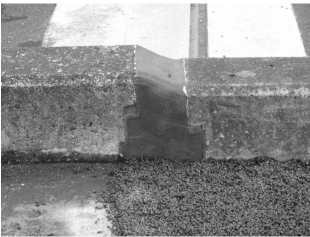
(b) 橋台位置の桁端部と背面の段差
