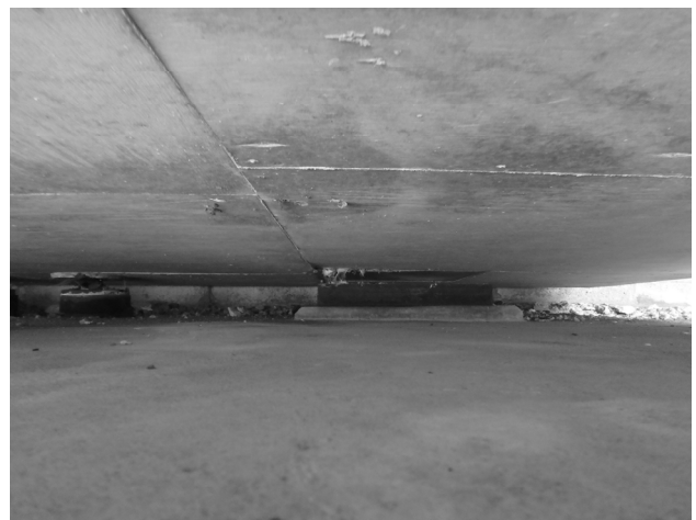
(d) 右岸側橋台の橋座位置での桁の浮き(橋台沈下)
