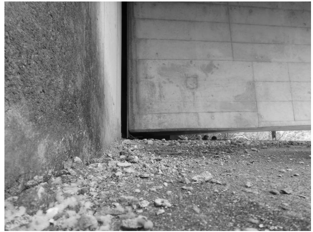
(c) 右岸側橋台の橋座位置の桁の浮き(橋台沈下)
