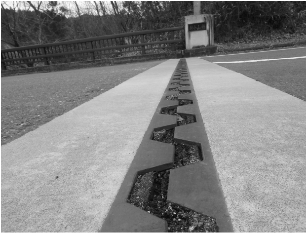
(a) 伸縮装置の橋軸方向開き
