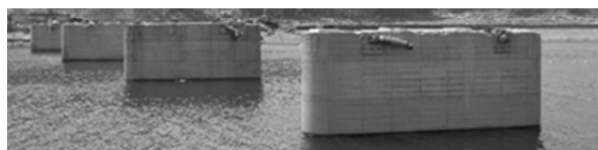
(b) 支承部の破壊により機能損失した橋
