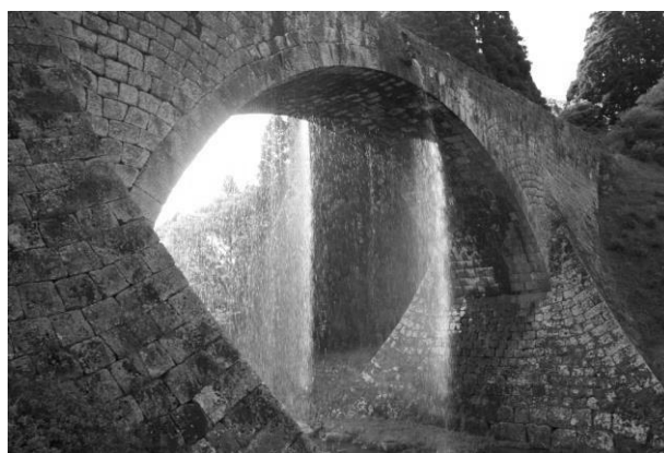
(c) アーチ輪石からの漏水状況
