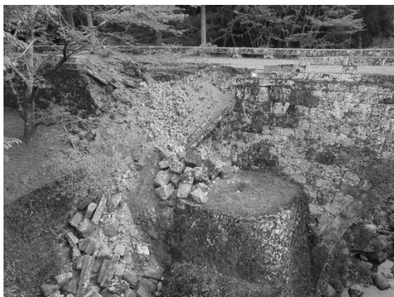
(c) 上流側の前震後の壁石の崩落状況
