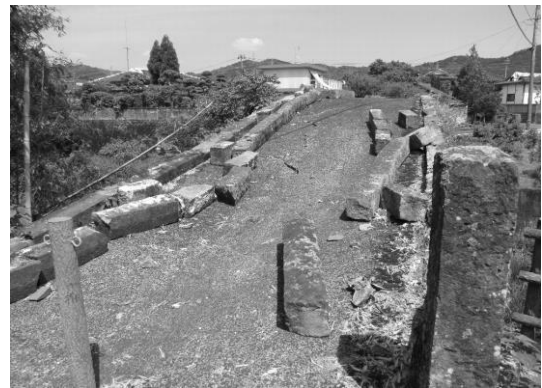
(d) 橋面上の高欄部の崩落状況
