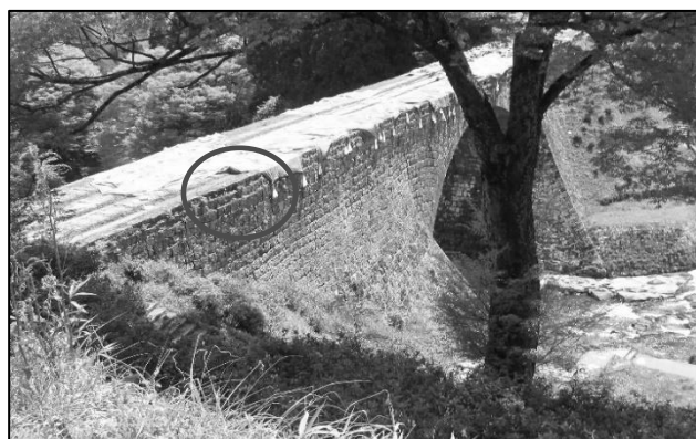
(d) 通潤橋の被災状況の全
