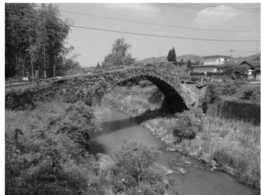
(b) 下鶴橋の壁石の崩壊状況
