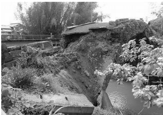
(c) 本震後の壁石の崩壊状況
