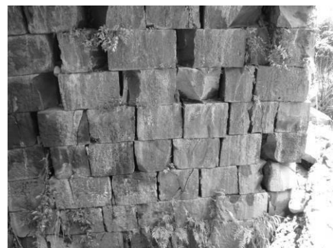
(f) アーチ基部下面の輪石の損傷とすき間状況
