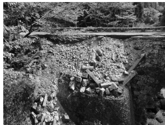
(d) 上流側の本震後の壁石の崩落状況
