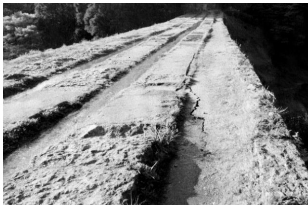
(a) 橋面上の亀裂の発生状況
