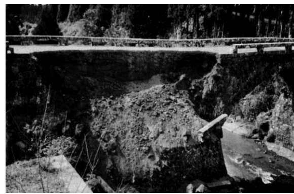
(b) 昭和 63 年の壁石の崩壊状況
