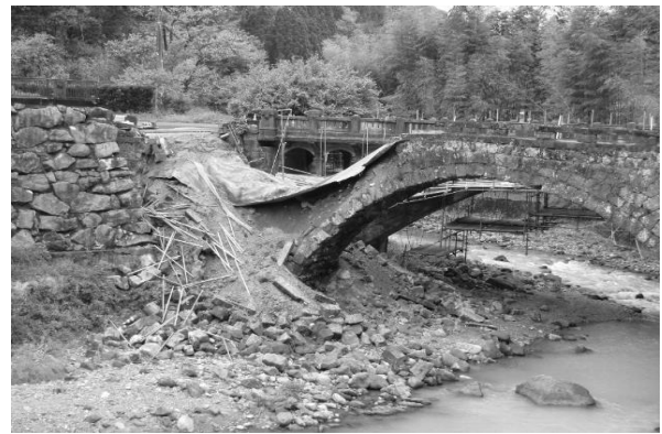
(b) 右岸下流側のアーチ輪石の崩壊状況
