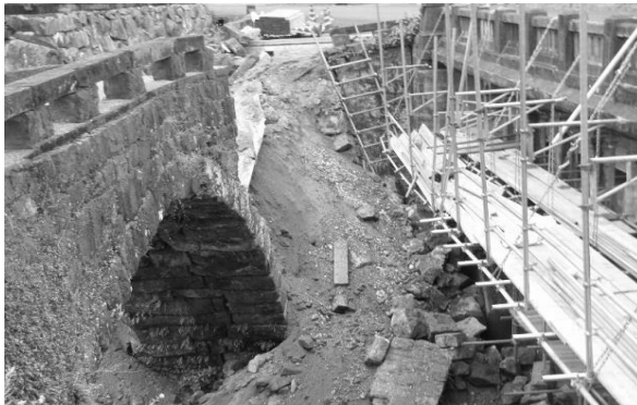
(c) 上流側のアーチ壁石の崩落状況
