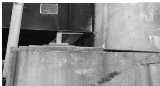
写真-8 A1 橋台の前面への移動・桁衝突
