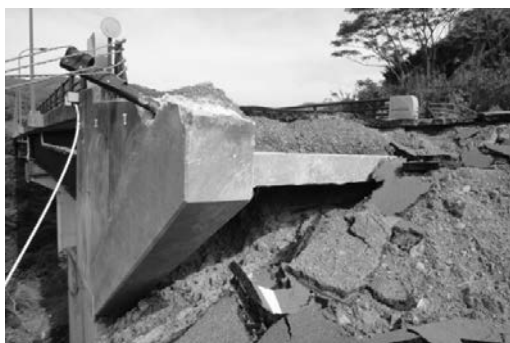
写真-7 A1 背面土の崩落
