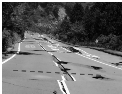
写真-1 阿蘇長陽大橋 A1 に向かう道路上の亀裂
