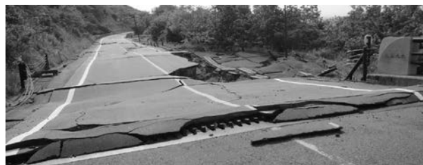
写真-9 A1 側背面土の状況と段差
