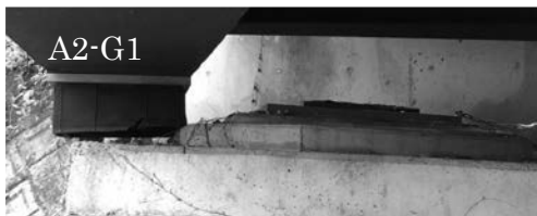
写真-H4 大切畑大橋のゴム支承破断状況
