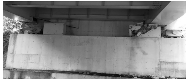
写真-20 A2 橋台支承部（変位制限ブロック破壊）
