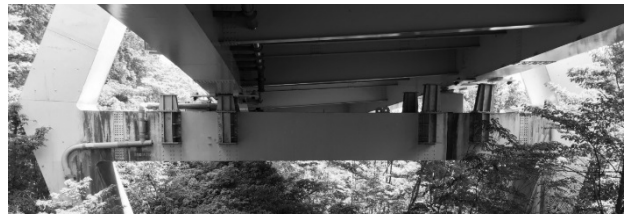
写真-19 主塔横梁上の変状
