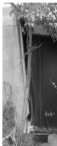
写真-11 A2-G1 端部の変状
