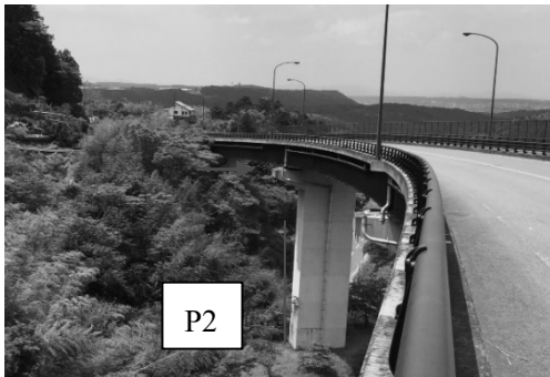
写真-H5 大切畑大橋の桁移動と P2 の傾斜状況
