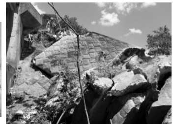
写真-5 A2 横の擁壁の崩落
