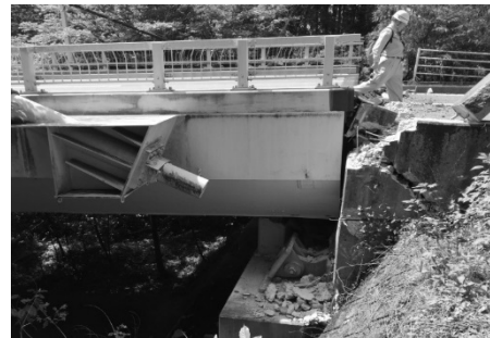
写真-21 A2 橋台に衝突・上方へ移動した桁
