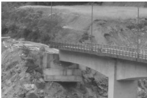
写真-3 崩壊後の A1 橋台の損傷状況
