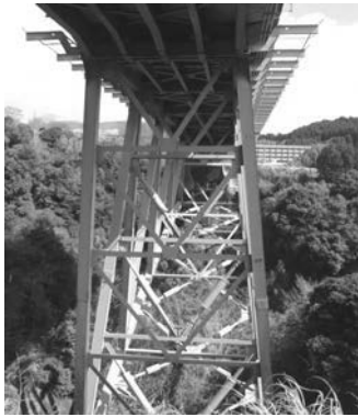
写真-H1 被災前の阿蘇大橋 (2011.3 撮影)
