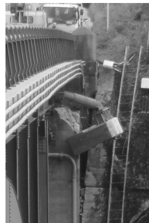
写真-H9 A2 側のダンパー
