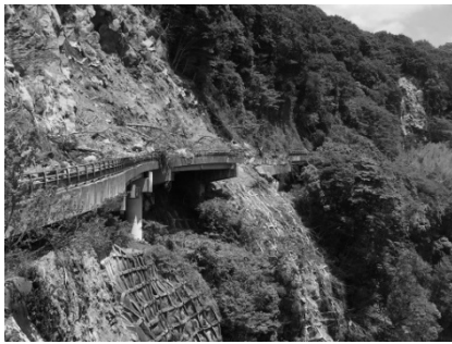
写真-H3 戸下大橋の崩落
