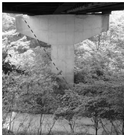
写真-10 P2 上の支承のずれと落下した G4 支承
