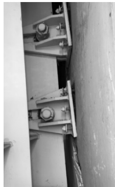
写真-18 A1 側桁変位制限装置
