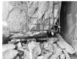
写真-4 A2 上の支承と露出鉄筋
