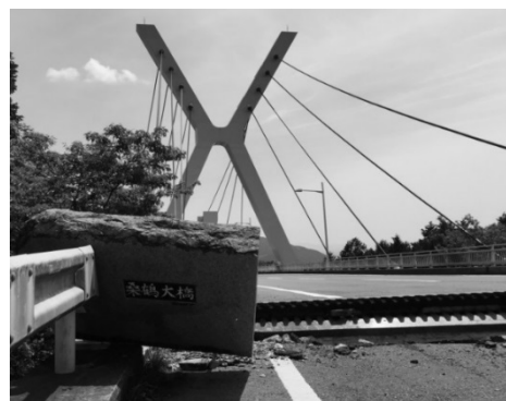
写真-22 主ケーブルの緩み
