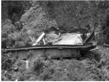
写真-H2 阿蘇大橋の単径間部の転落状況
