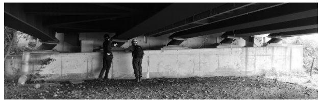
写真-H6 扇ノ坂橋 A1 上のゴム支承の変形
