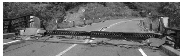
写真-13 A2 桁端部の沈下
