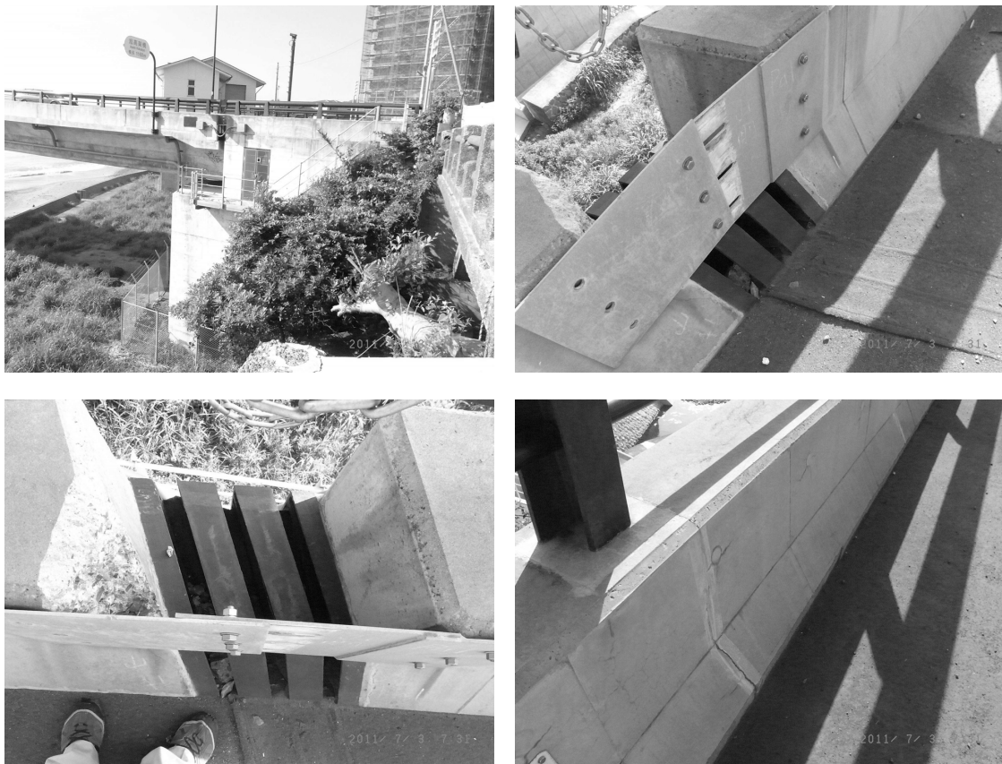
写真-3 As1 橋台位置の損傷状況
