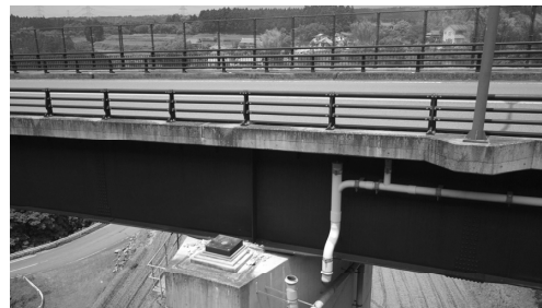
写真-4 大切畑大橋（ゴム支承部分の損傷）
