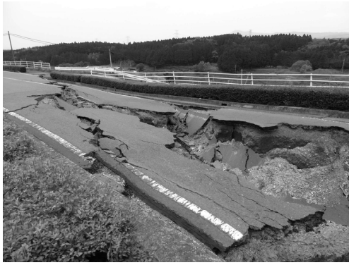
写真-1 大切畑大橋付近の道路被害
