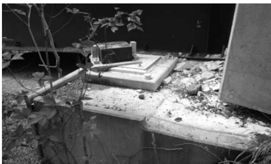
写真-5 ゴム支承破壊、 A2 橋台のパラペット下端破断
