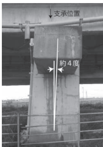
(i) 橋脚の傾斜(P11)
