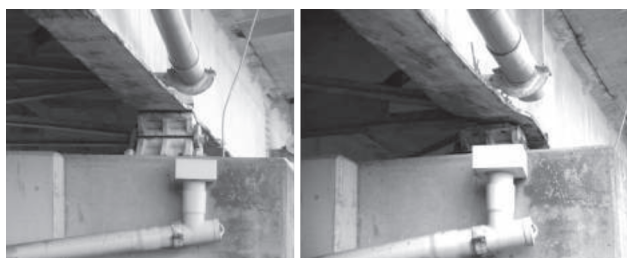
(i) 前震後 (4/15 撮影) (ii) 本震後 (4/16 撮影)
