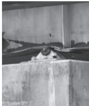
(ii) 固定支承上沓の落下
