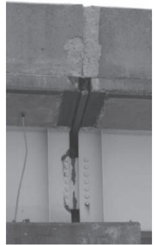
(iii) 連結板の座屈
