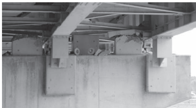
(i) 鋼製支承破壊による横変位拘束構造の損傷(P21)
