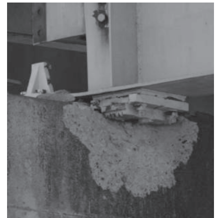
(iii) 可動支承ローラーの逸脱
