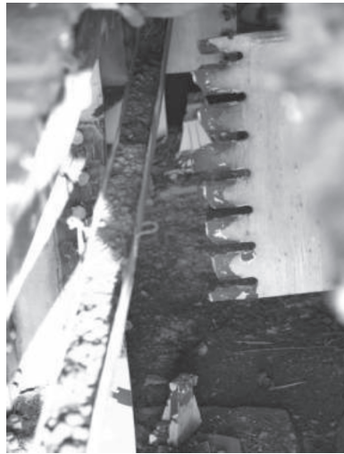
(ii) 連結板孔部の破断
