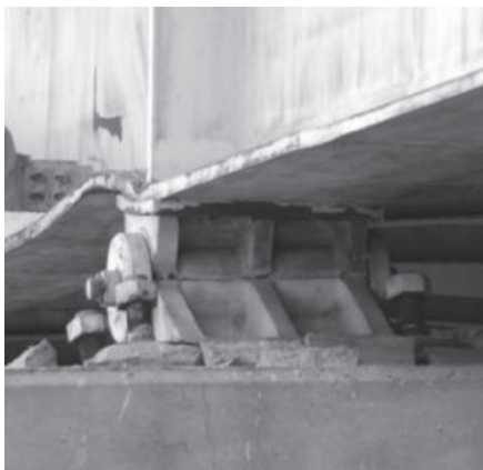
(i) アンカーの抜け出し
