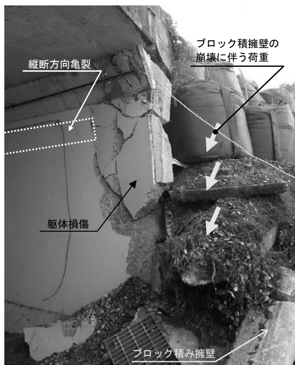
(a) 西側坑口部の被害
