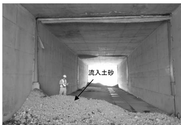
写真-2 被害の状況(熊本 33)
