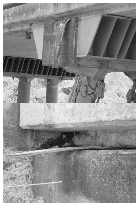
写真-1 益城町第一畑中橋の帯状ゴム沓の迫り出し
