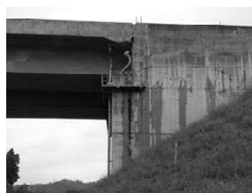
写真-1 桁衝突による橋台損傷事例
