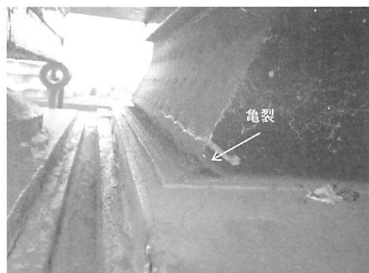
写真-1 ギョムダンパーに発生した亀裂損傷
