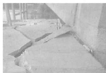
写真-1 サイドストッパー破損状況
