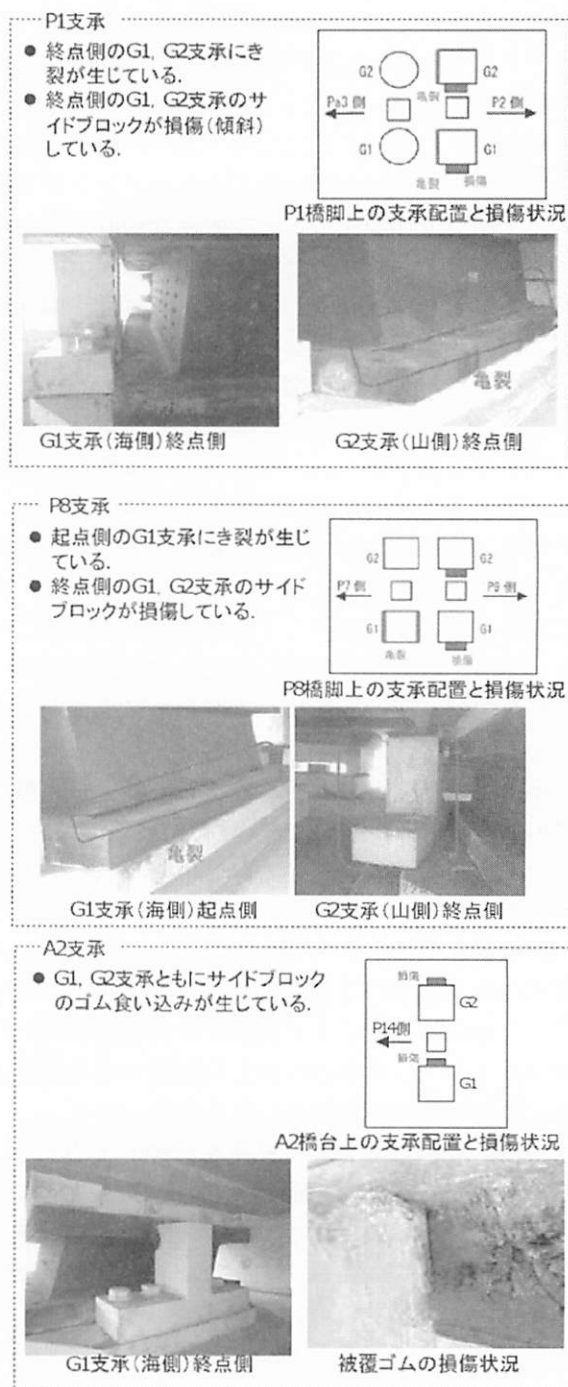
図-19 サイドブロックの損傷状況 5)
