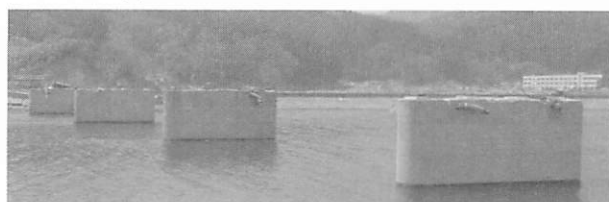
(b) 被災後 写真-1 気仙大橋全景
