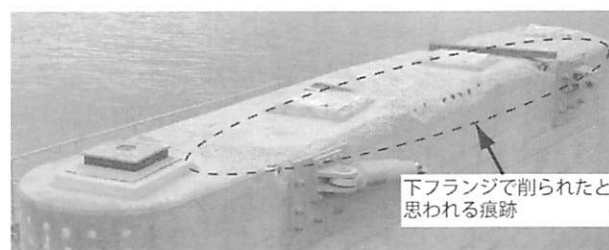
写真-11 P4 橋脚の損傷痕
