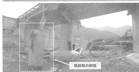
(a) 上部構造の流出と橋脚部の倒壊
