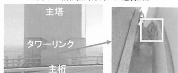
図-4 タワーリンク(左)とボルト破断の状況(四角部)
