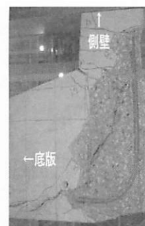
c) 隅角部損傷 (下側)
