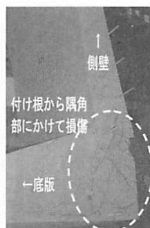
b) 隅角部損傷 (上側)
