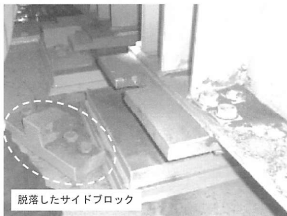
図-1 橋脚上に脱落した支承サイドブロック
