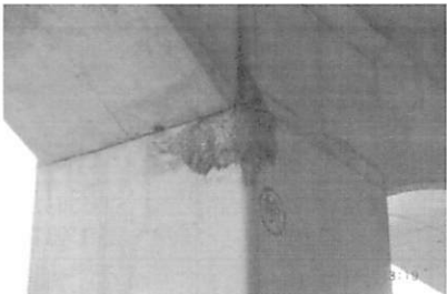
図-10 東北地方太平洋沖地震による対象高架橋のかぶりコンクリートの剥離
