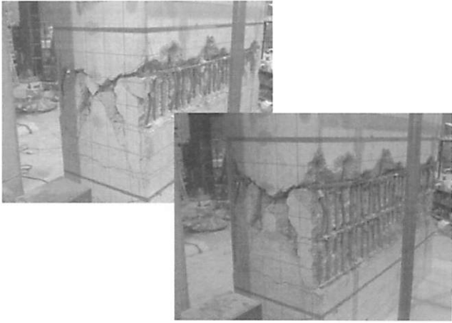
①No.1 供試体の損傷状況とはつり後の状況
