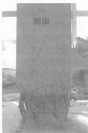
(b) 試験終了後（補強材撤去）
