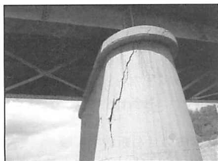
写真-1 壁式橋脚における橋座部のせん断破壊 1)
