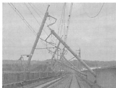
図-1 東北地方太平洋沖地震における東北新幹線高架橋上の電車線柱の損傷 2)
