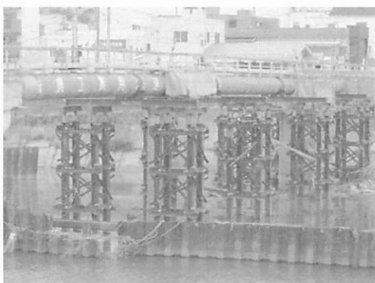
写真-7 水管橋の桁部の被害
