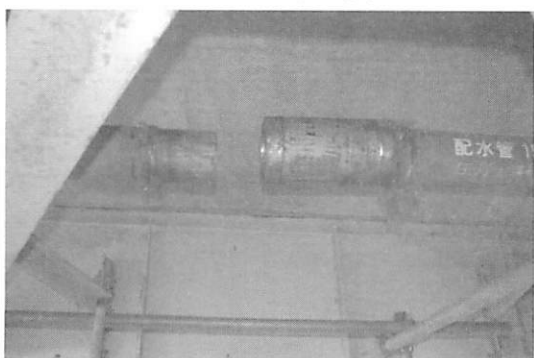
写真-10 水道管の被害
