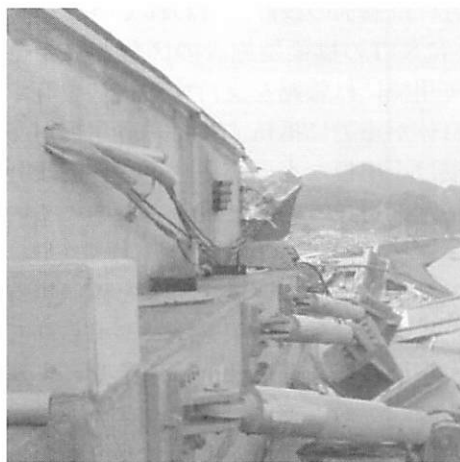
写真-11 橋桁の流出
