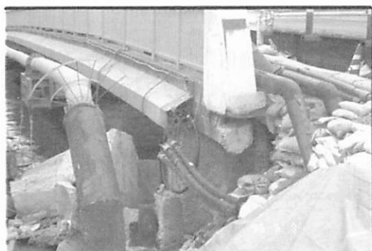
写真-2 橋台の被害
