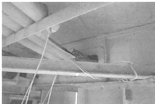
写真-8 電力管の被害
