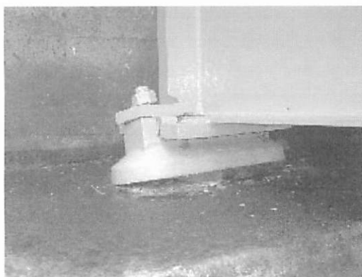
写真-1 鋼桁橋の支承の被害
