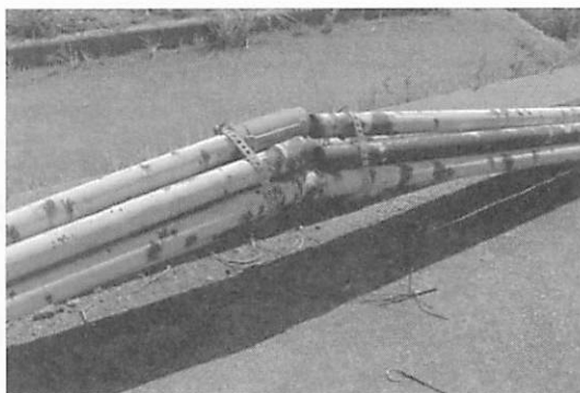
写真-5 地上配管の被害
