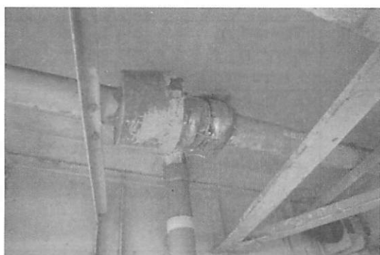
写真-9 ガス管の被害
