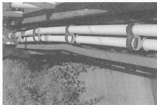
写真-4 鋼桁橋の被害
