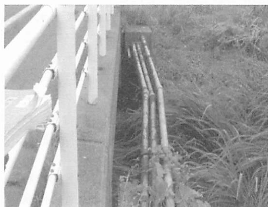
写真-3 管橋の被害
