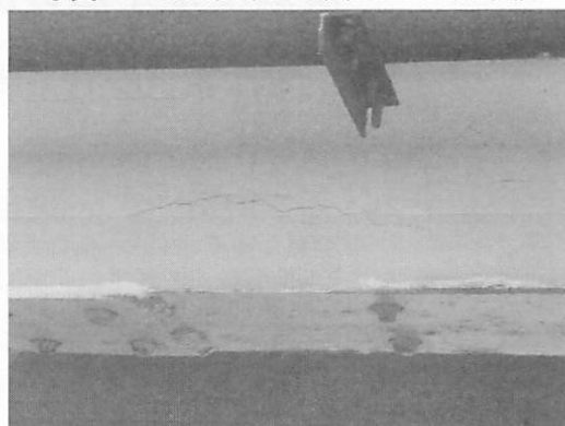
(a) 主桁部分の補修跡と補修後に発生したひび割れ
