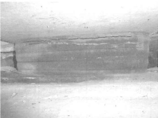
写真-1 損傷状況
