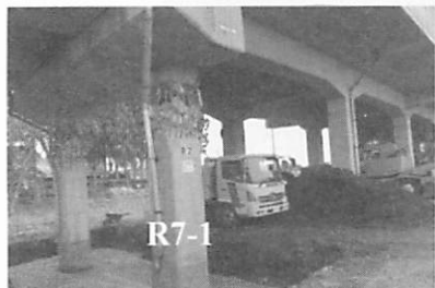
図-13 第1中曽根高架橋 の被害状況 15)
