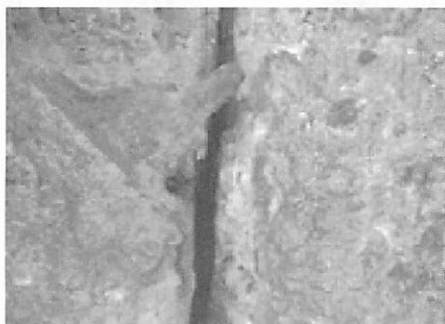
写真-2 P1上での遊間状況
