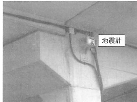
(b) 高架橋地震計の設置状況
