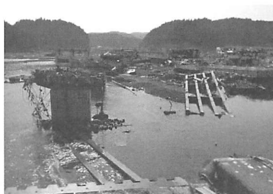
写真-1 津波による上部構造流出被害例
