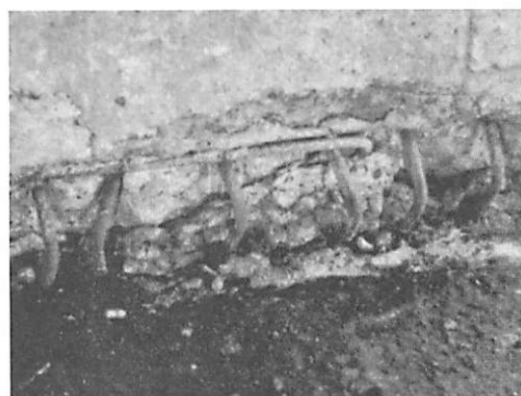
写真-1 橋脚基部の軸方向鉄筋の座屈 1)
