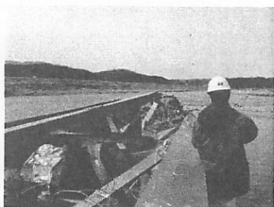
(b) 流出した桁
