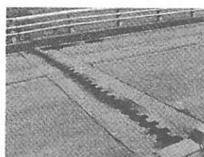
(b) 伸縮装置の被害
