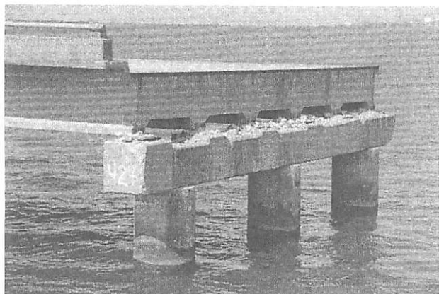
写真-6 被害当時のままに残されている落橋部 (I-10)
