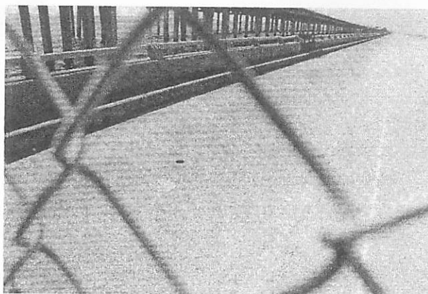
写真-12 床版に開けられた穴 (I-10)
