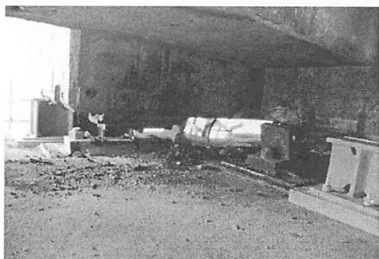
写真-28 完全に逸脱したローラー (向こう側と手前のローラー支承)
