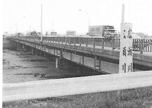
写真-1 千代大橋 (1978年宮城県沖地震)
