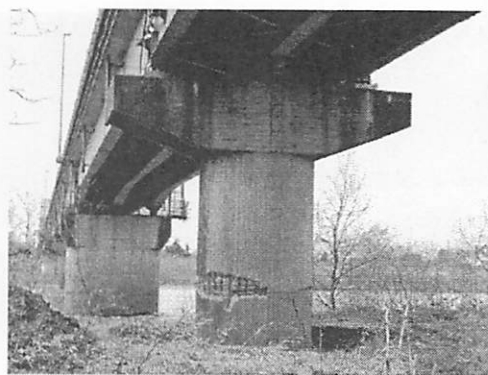
写真-30 主鉄筋段落し部で破壊した藤橋 ( (独) 土木研究所構造物メンテナンス 研究センター星隈氏による)
