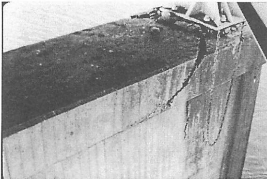
写真-16 落橋寸前であった支承下橋脚頂部の被害 (1978 年宮城県沖地震)
