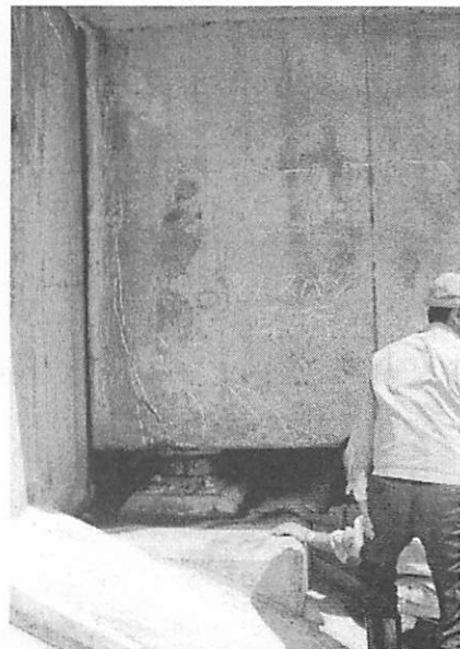
写真-25 桁端部支承位置のクラック (1978年宮城県沖地震)
