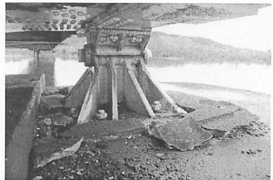
写真-20 ピン支承固定部の被害
