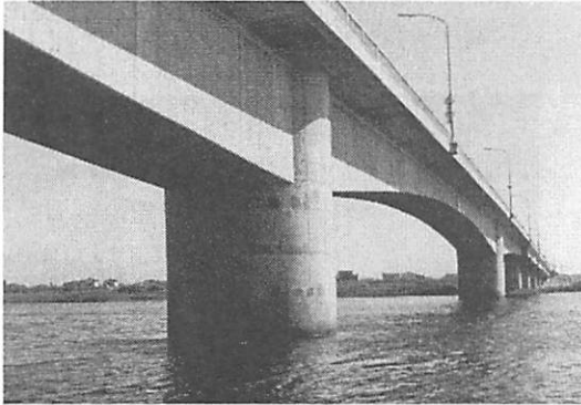
写真-22 関上大橋 (1978年宮城県沖地震)
