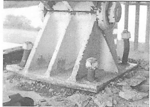
写真-13 ピンが破断したピン支承 (1978年宮城県沖地震)
