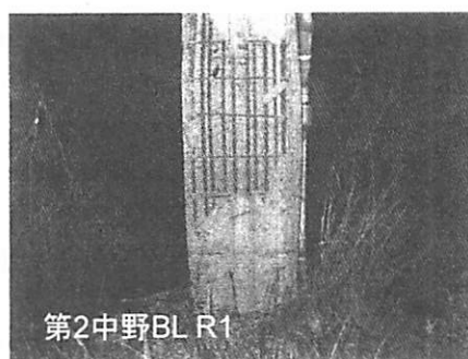
写真-7 2003年三陸南地震による高架橋の被害 1)
