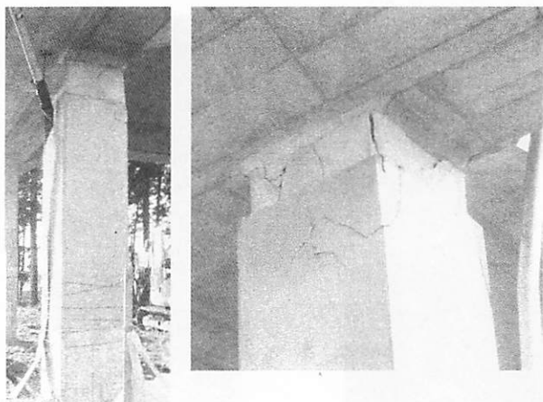
写真-12 4月7日の余震による損傷
