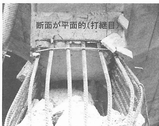
写真-9 R7柱破壊部の断面
