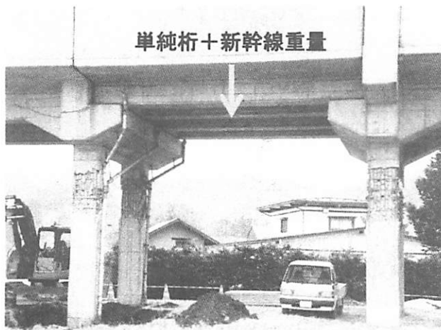
写真-10 端部柱の損傷とゲルバー桁
