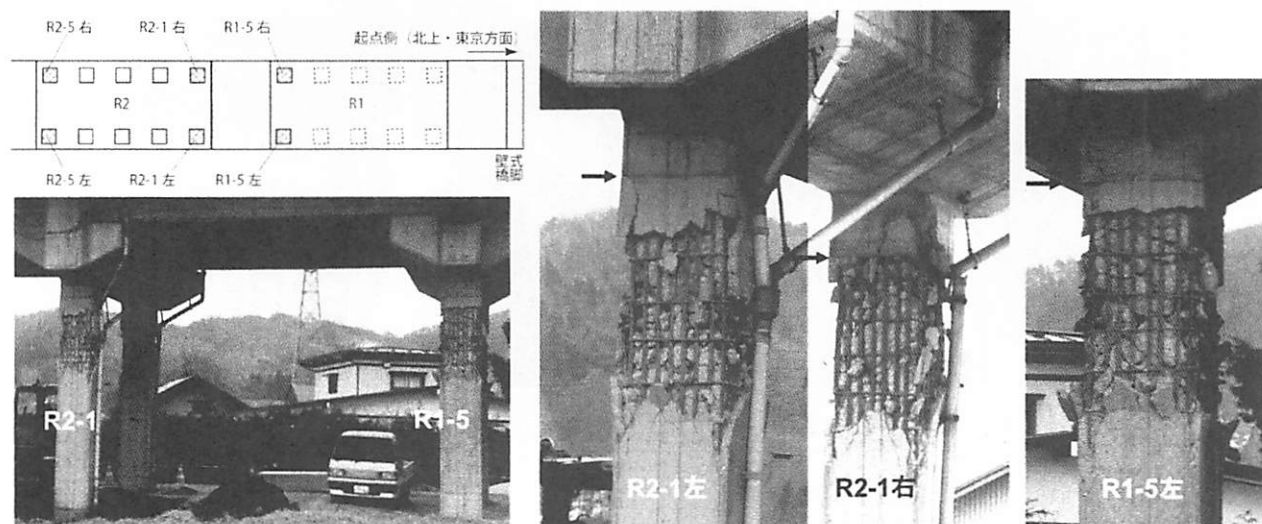
写真-2 R1, 2 における端部柱の被害
