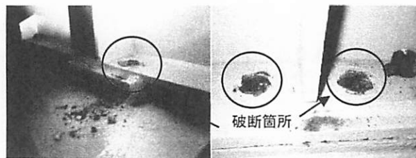
写真-3 床組み縦桁支承セットボルト損傷状況
