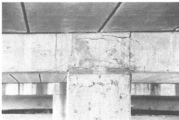
写真-9 Anzac 橋梁柱接合部の損傷
