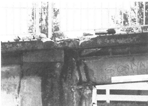
写真-3 Moorhouse Ave/Colombo St 跨道橋の桁衝突部
