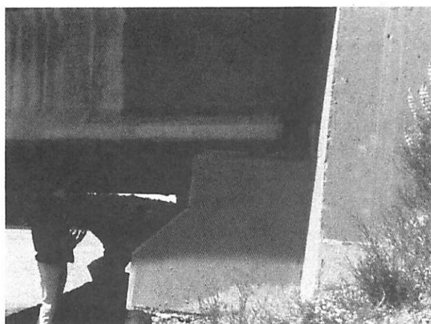
写真-6 2010年Darfield地震によるSouth Brighton 橋 橋台部の傾斜（Omer教授・東海大提供）
