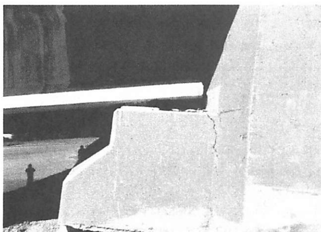
写真-7 今回の地震による橋台部傾斜の進行
