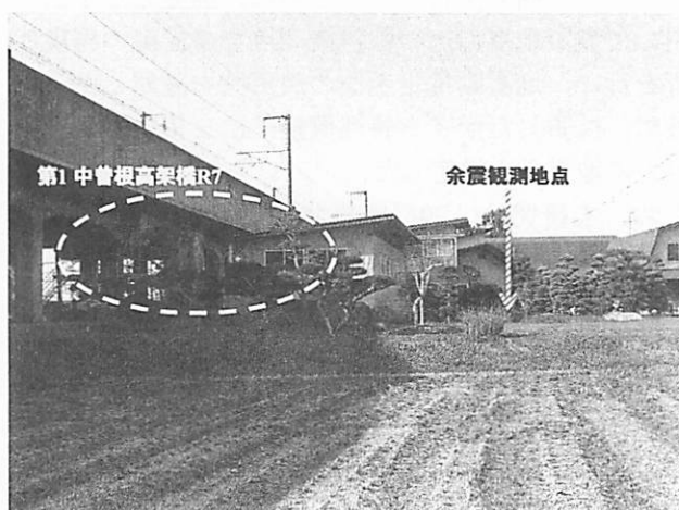
写真-1 被災した第1中曽根高架橋R7と余震観測地点
