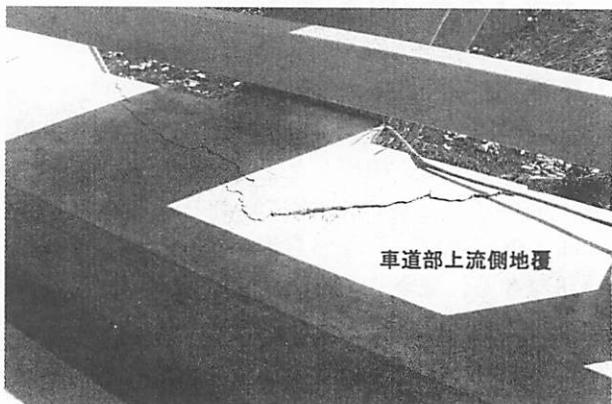
写真-2 格点部地覆の損傷
