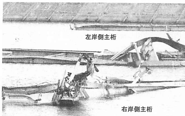
写真-3 流出主桁
