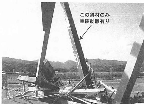
写真-1 斜材の塗装剥離
